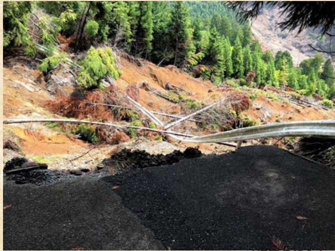
反対側から 見た 崩壊現場
